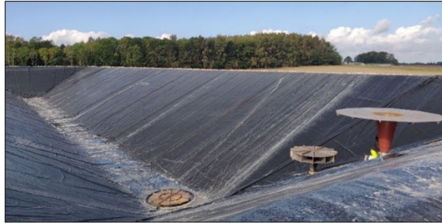
Water pit thermal energy storage system in Høje Taastrup
